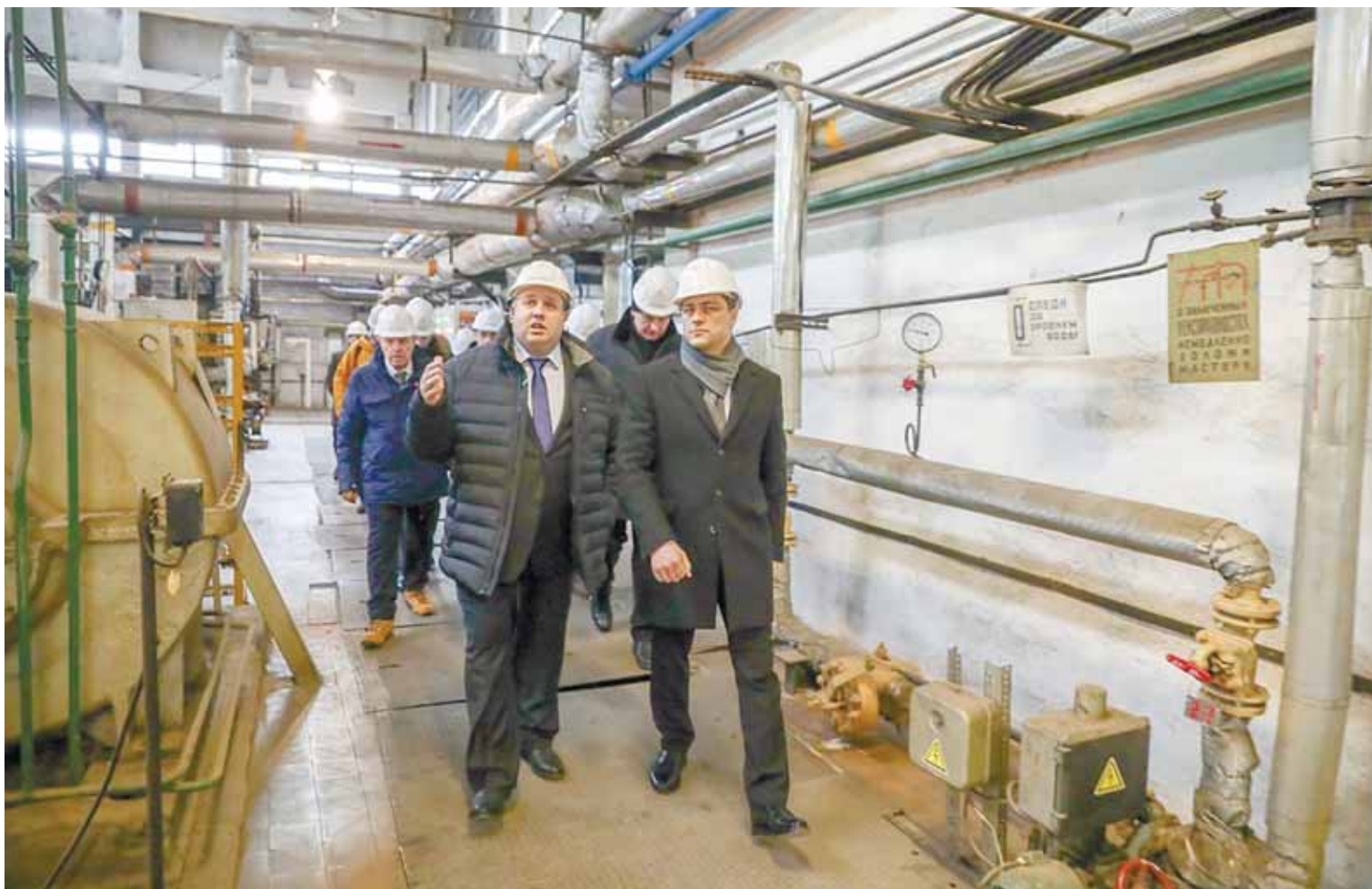
Александр Баранов и Михаил Ведерников в котельной «Невы Энергии». / Фото: пресс-служба администрации Псковской области
